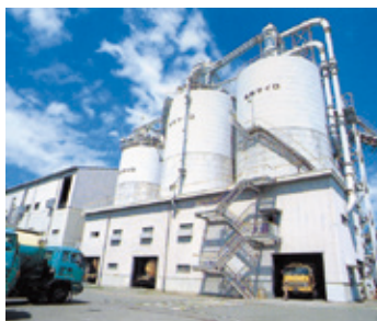
フライアッシュ払出設備
