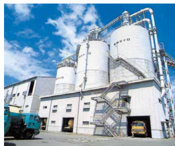
フライアッシュ払出設備
