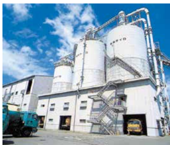
フライアッシュ払出設備
