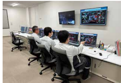
バイオマス発電所の運転業務
