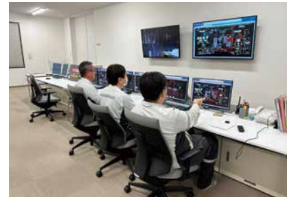
バイオマス発電所の運転業務
