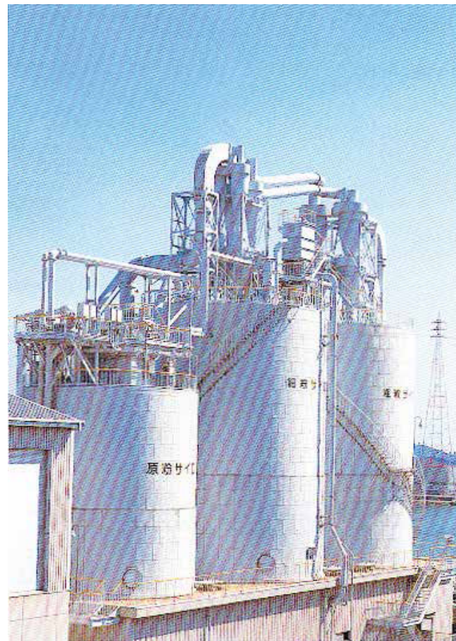
●四国電力(株) 西条発電所フライアッシュ貯蔵設備
